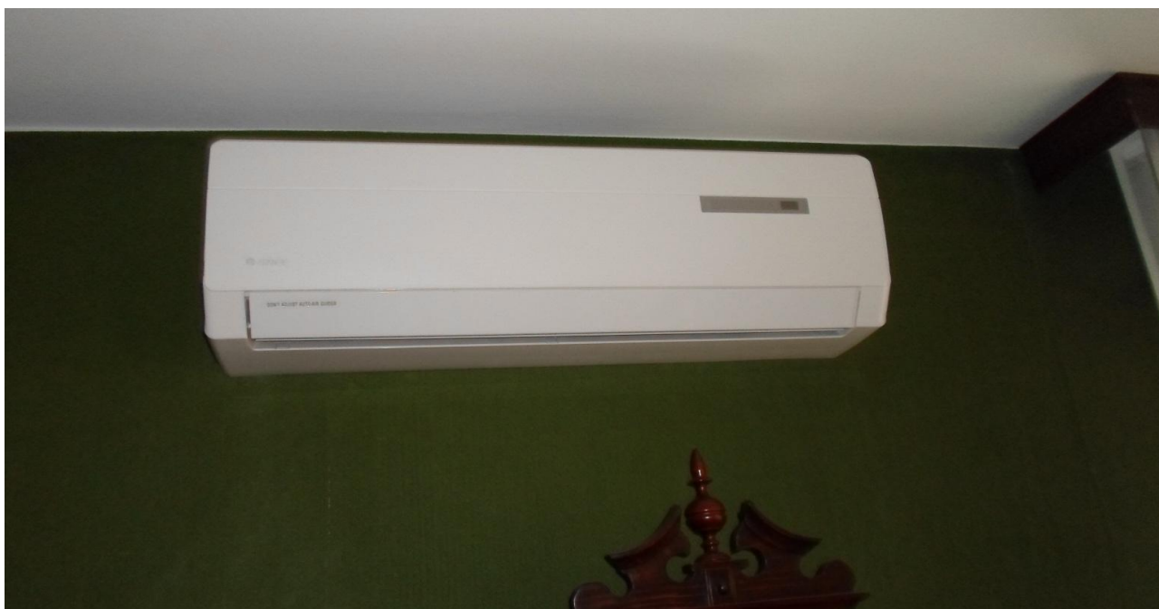
Slika 11. Unutarnja klima jedinica za grijanje i hlađenje objekta
